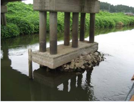
河床低下の影響を受けた橋脚 (新川橋) 河床低下により橋脚基礎部が露出
