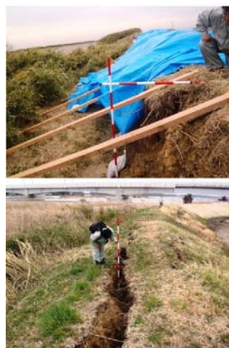
東北地方太平洋沖地震による堤防被災状況
