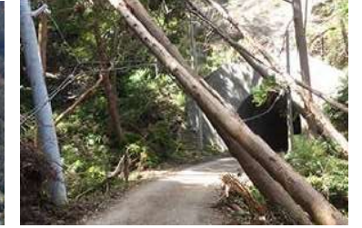
⑧倒木・倒壊の状況 (千葉県鴨川市)
