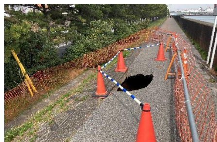
陥没状況写真
