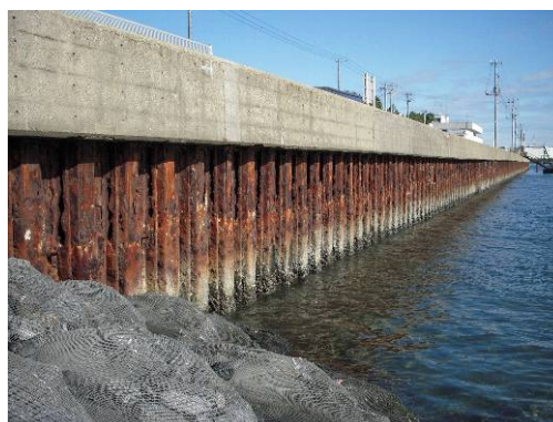
鋼矢板が腐食し老朽化が著しい現況護岸 (手前の袋詰めネットは応急的に補強したもの)
