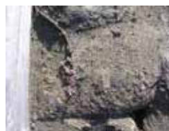
試験開始6ヵ月後(H21年9月)から土嚢袋の破けが見え始める
