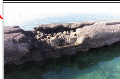
写真-2. 上部工欠損状況
