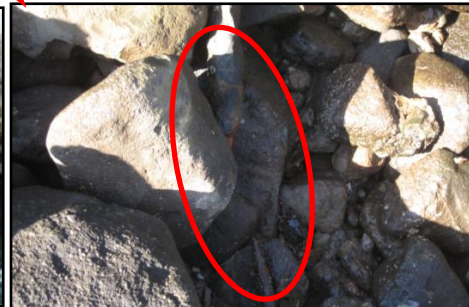
写真-5. タイロッド破断状況
