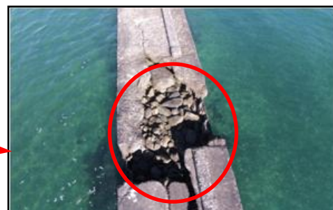
写真-1. 中詰石露出状況
