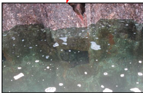
写真-3. 鋼矢板腐食状況
