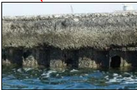
写真-4. 鋼矢板腐食状況
