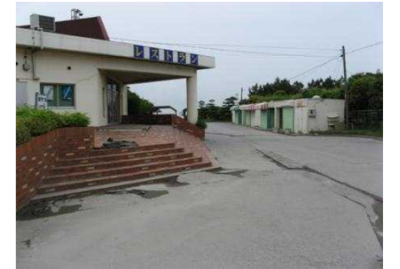
施設が一部損壊
