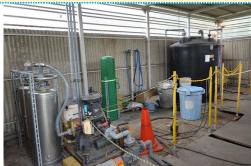
排水処理施設
