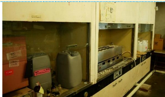
排ガス処理施設 (屋内側)
