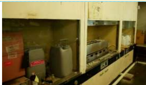
排ガス処理施設 (屋内側)
