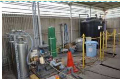
排水処理施設
