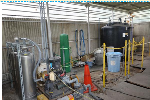
排水処理施設
