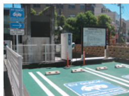
県庁敷地内の急速充電器
