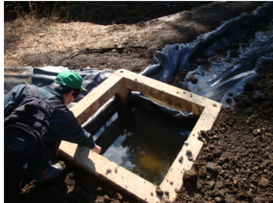
↑残土事業場の立入検査
