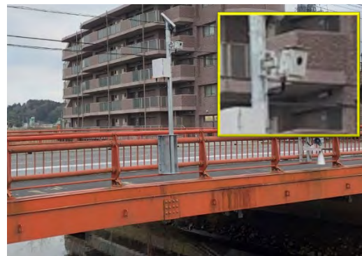
▲簡易型河川監視カメラ
