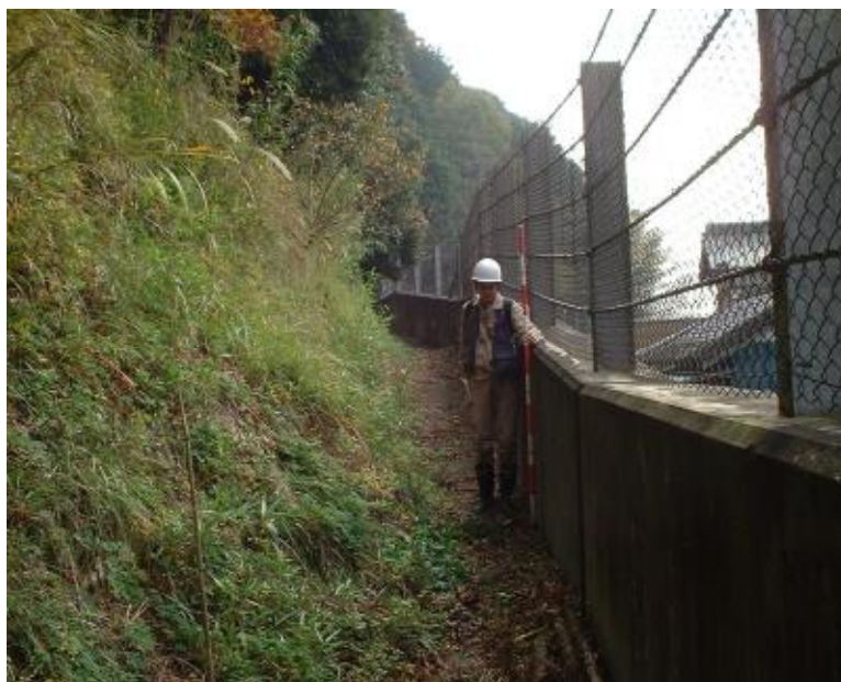
写真4. 3. 2 待受対策施設ポケット状況
