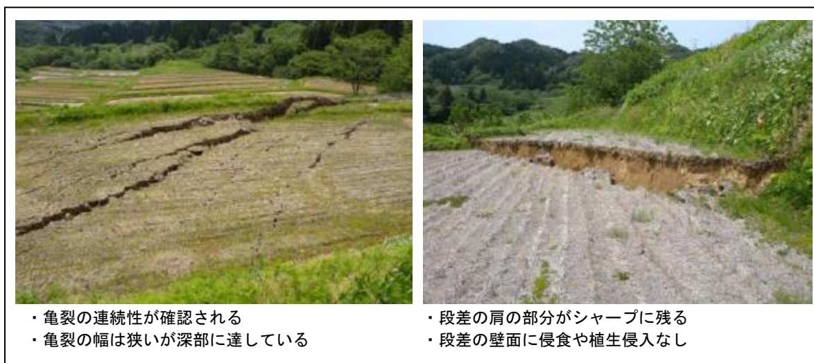
図 4.6-16 明瞭な地滑り変状の例
