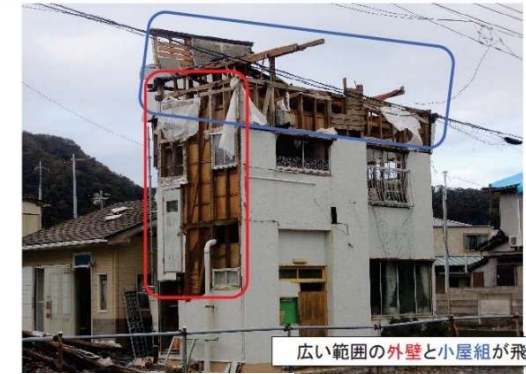
建築物の被害(千葉県鋸南町)
