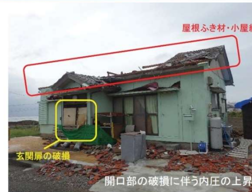
建築物の被害(南房総市白浜町)
