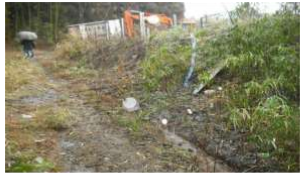
水中ポンプのホースが伸びてきている
