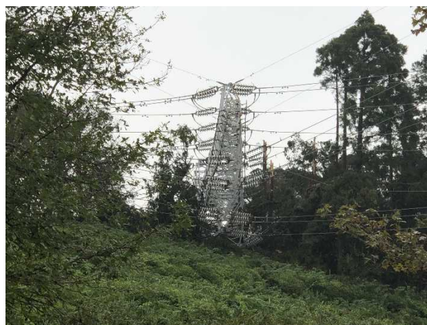
君津市かずさ小糸（鉄塔倒壊）
