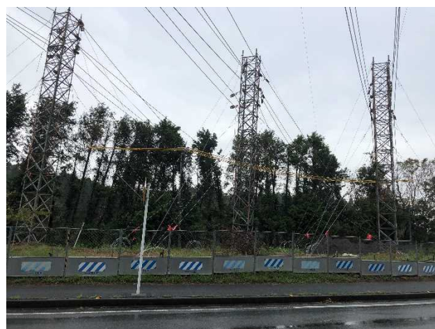
君津市かずさ小糸（鉄塔倒壊）
