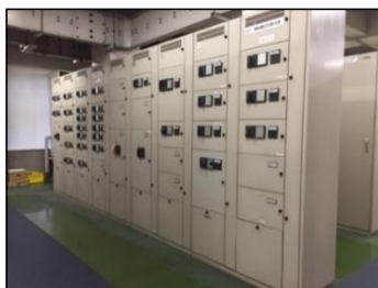
運転操作設備
