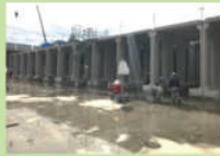
地下式雨水貯留槽
