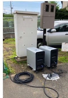
可搬型蓄電池の設置例
