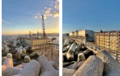
防湖堤工事に使用：海水による腐食・錆び浮きが無く、簡単なメンテナンスで次現場への転用が可能です。
