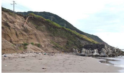
季節風と高波による浸食 道路施設が崩壊の危険（新潟市）
