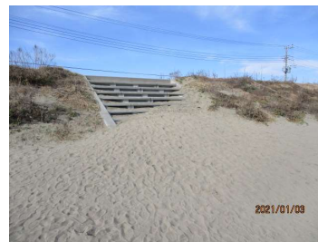
土堤海側の堆積 （九十九里町・片貝IC付近）
