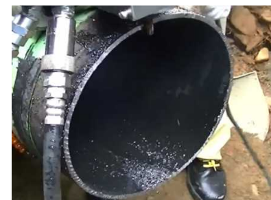
(6)切断面の様子
