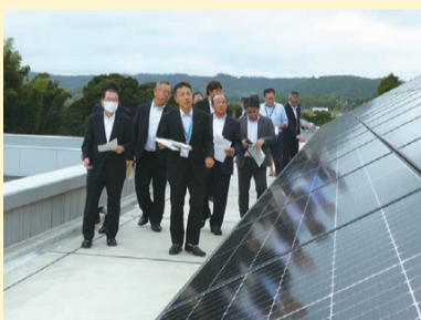
蓄電池を備えた太陽光発電設備の説明を受ける委員
