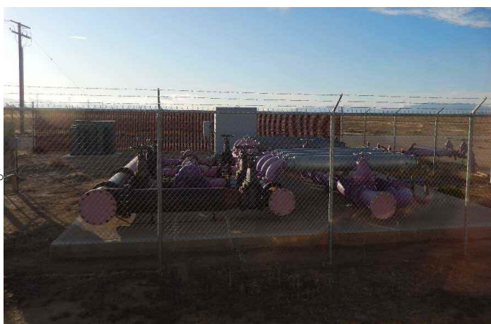
下水処理水を送るポンプ
