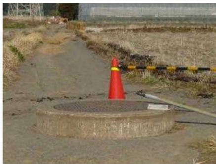
人孔（マンホール）の突出
