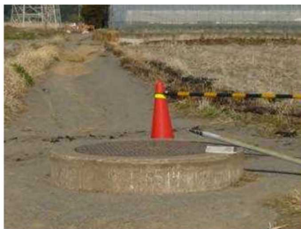
人孔（マンホール）の突出
