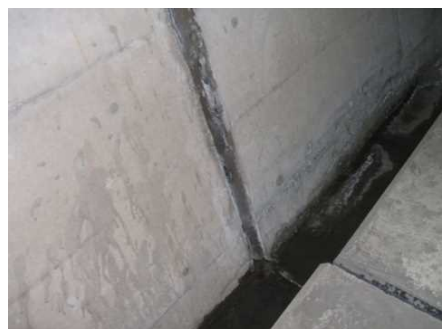
処理場管廊内の躯体のずれ
