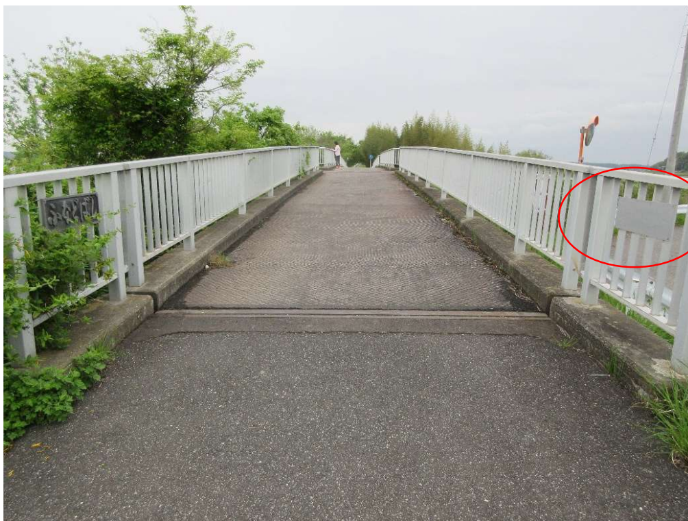
発生箇所⑥(盗難発生後)
