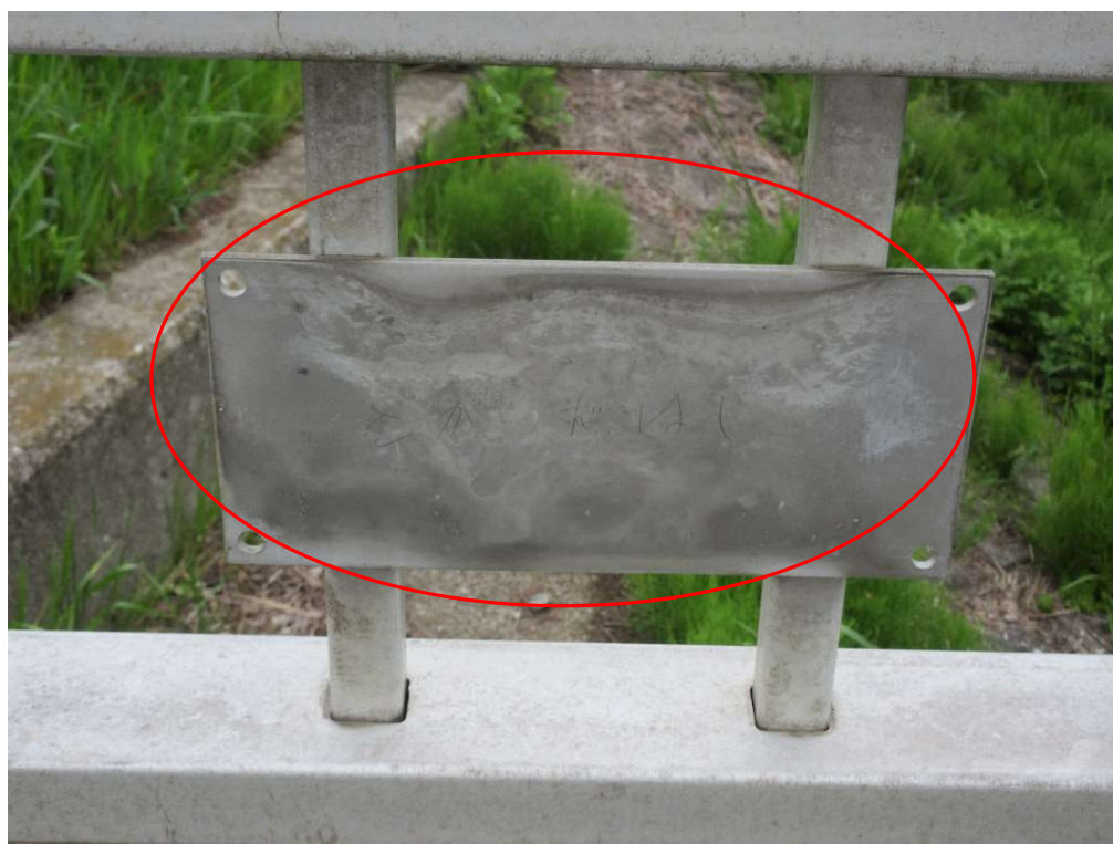
発生箇所④(盗難発生後)
