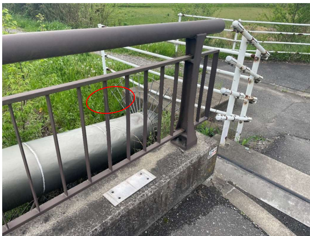
発生箇所③(盗難発生後)
