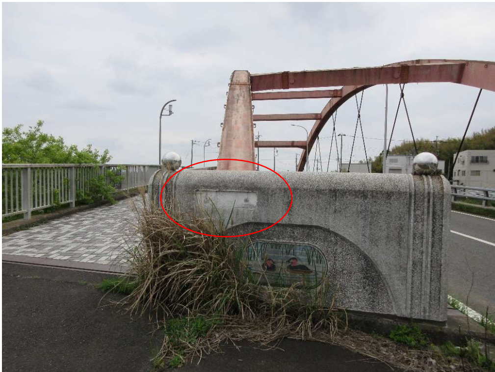
発生箇所⑤(盗難発生後)
