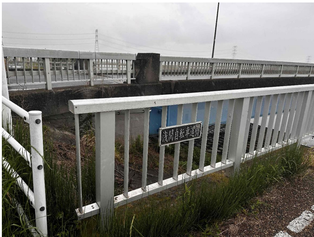
発生箇所 浅間自転車道橋（盗難発生前）
