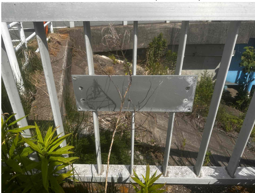
発生箇所 浅間自転車道橋（盗難発生後）
