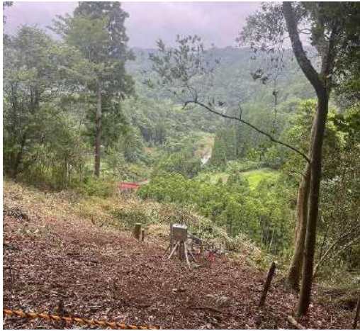
伸縮計によるクラック幅観測
