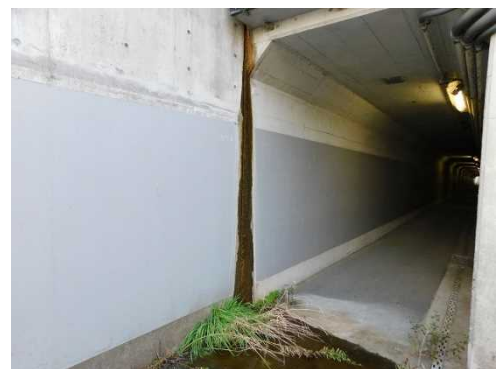
目地部からの漏水が発生しています。
