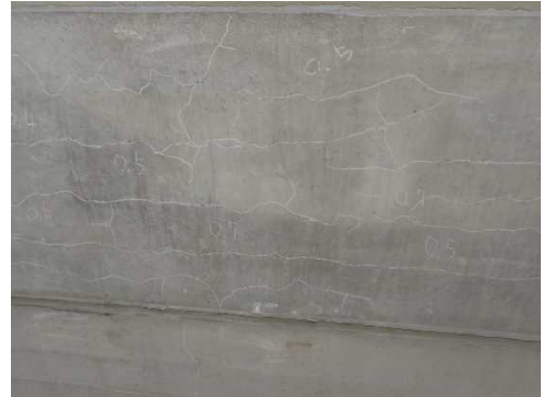
カルバート本体に、網目状のひびわれが多数発生しています。
