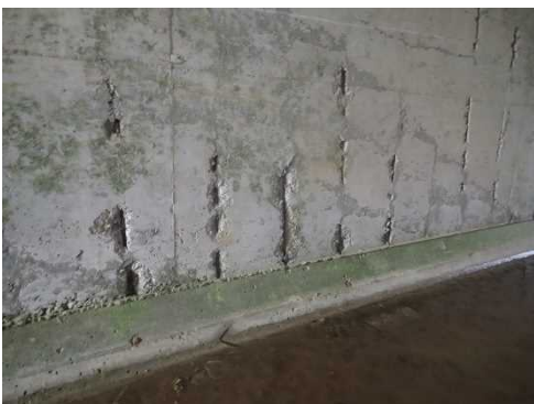
コンクリート内部の鉄筋の腐食を伴う、コンクリートの剥離・鉄筋露出が発生しています。
