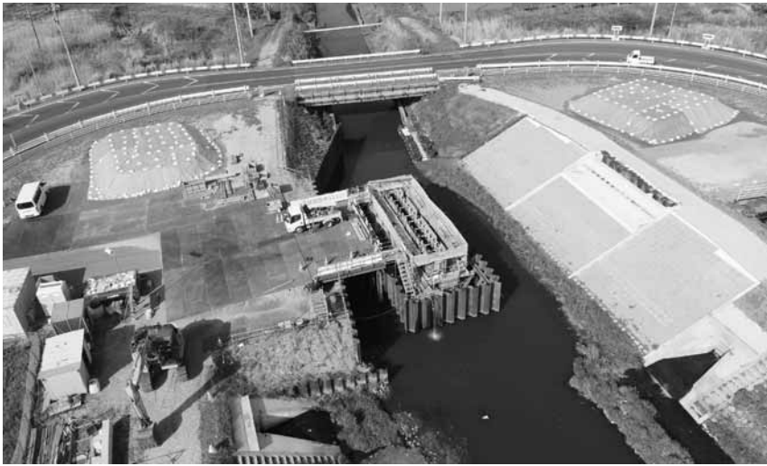
総合流域防災事業 (二級河川真亀川水系真亀川) 東金市家徳
