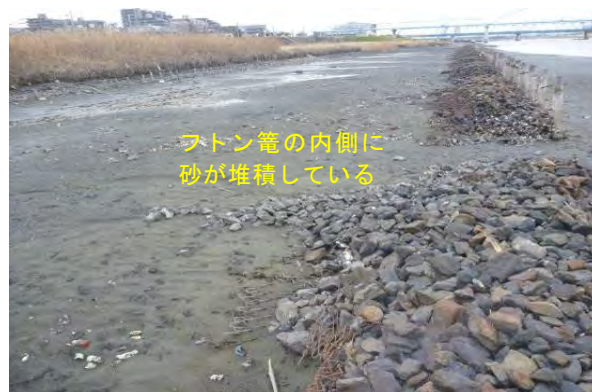
全体的に砂質化傾向であったが、特にフトン籠の内側に砂が堆積していた（H23.3 撮影）。
