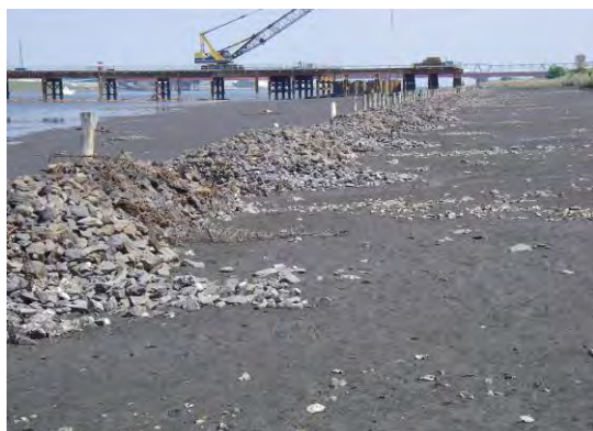
フトン籠の中の石が岸側に散乱した（工事箇所上流側 H 23.5 撮影）。
