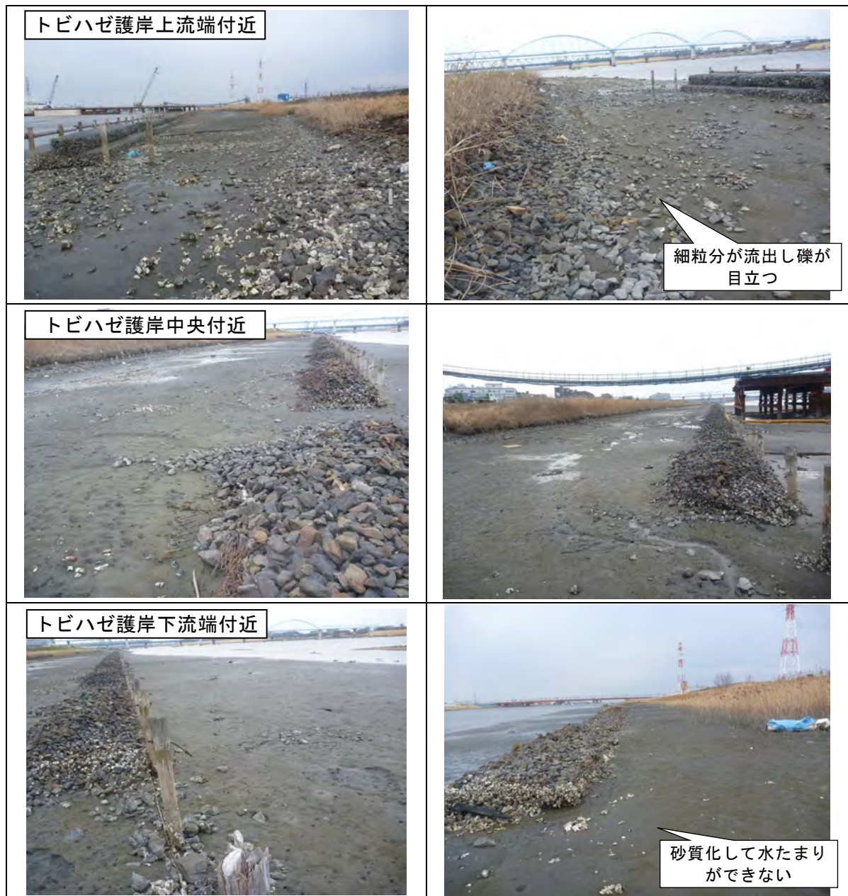
図 5-29 東日本大震災直後のトビハゼ護岸部の状況（平成 23 年 3 月 25 日撮影）
