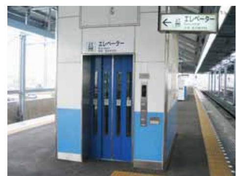
〔エレベーター〕
