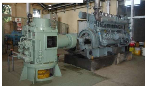
川中島終末処理場雨水ポンプ (茂原市)
