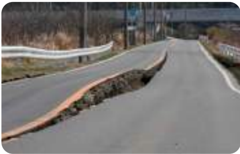
もり上がってひびが入った道路
