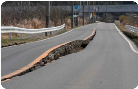
もり上がってひびが入った道路
