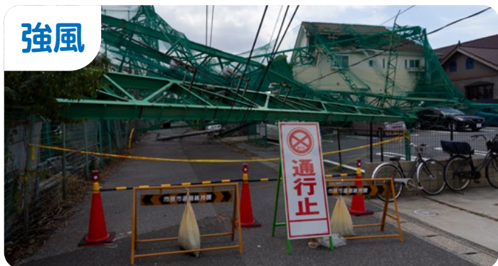
強風により飛ばされた鉄柱
