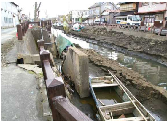
写真 3-4-15(179 ページ) 液状化と側方流動による噴砂と護岸倒壊 (香取市・小野川：県土整備部提供)
