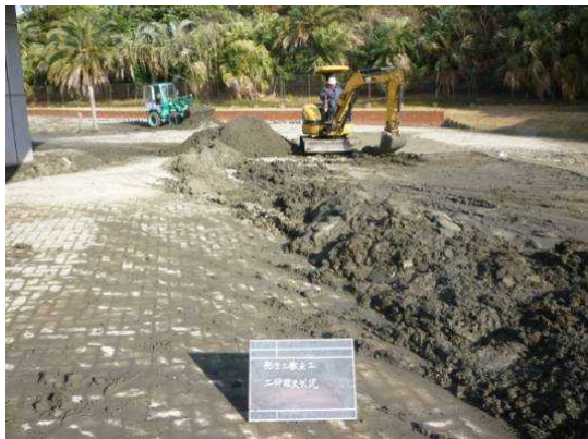
写真 3-12-13(232 ページ) 応急措置及び応急復旧状況 (千葉市・幕張海浜公園：県土整備部提供)
