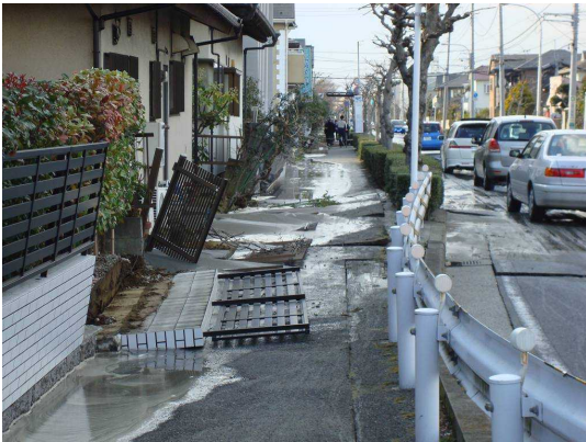
写真 1-3-8 (58 ページ) 道路の隆起、土砂の噴き出しが発生した。 (習志野市香澄：習志野市提供)
