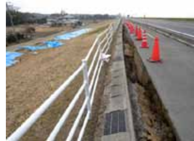
写真 3-4-3 (国)356号 法面崩壊による路面亀裂
