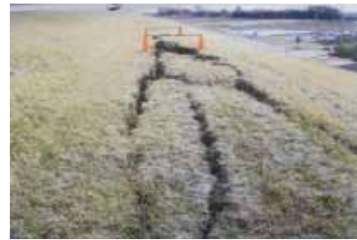
写真 3-4-4 (国)356号 法面崩壊による路面亀裂
