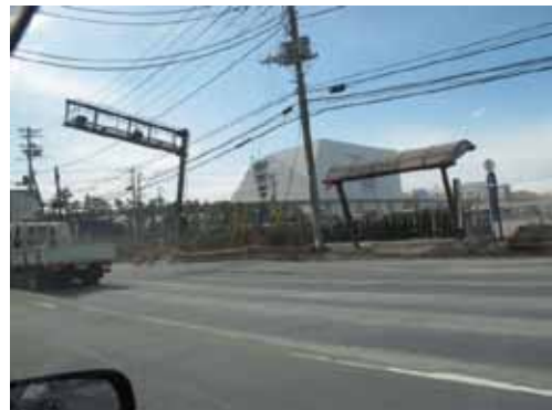
写真 3-4-14 傾いたバス停と電柱等（浦安市）
