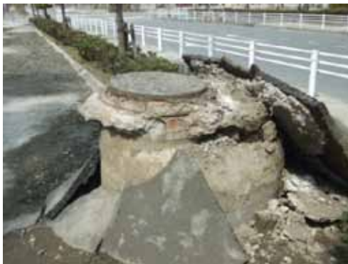
写真 3-4-13 マンホールの異常隆起（浦安市）
