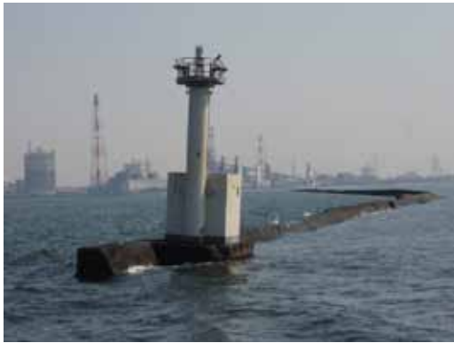
写真 3-4-9 堤防の沈下（被災状況）
