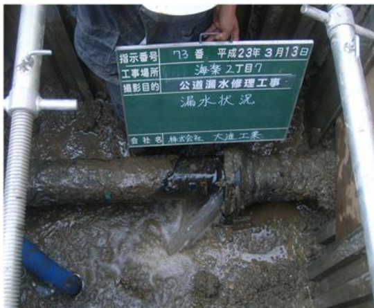
写真 3-11-3 修繕前の状況
