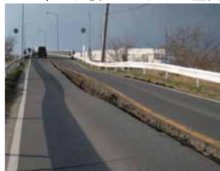
写真 3-4-5 (国)464号 路床崩壊による段差状況
