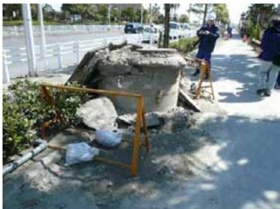
写真 3-12-19 マンホール浮上状況
