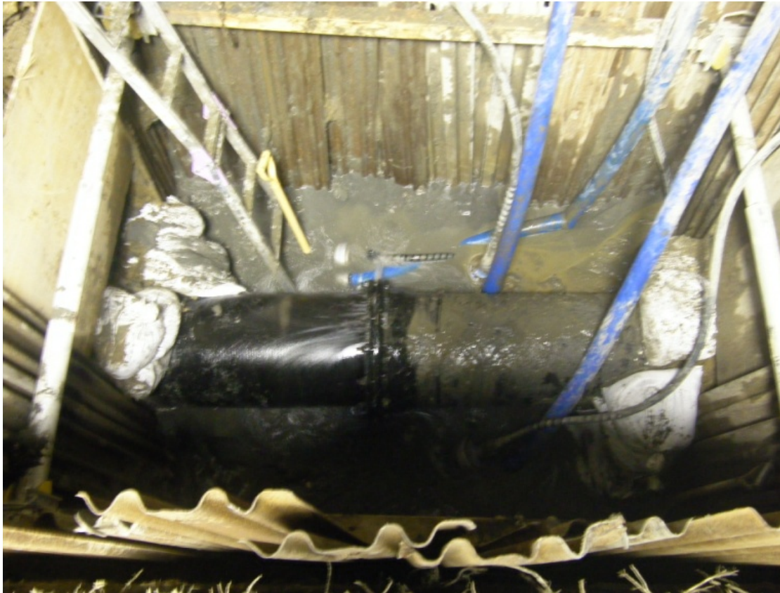
写真 3-11-7 南行徳～高洲線 φ 500 漏水写真（浦安市今川地先）
