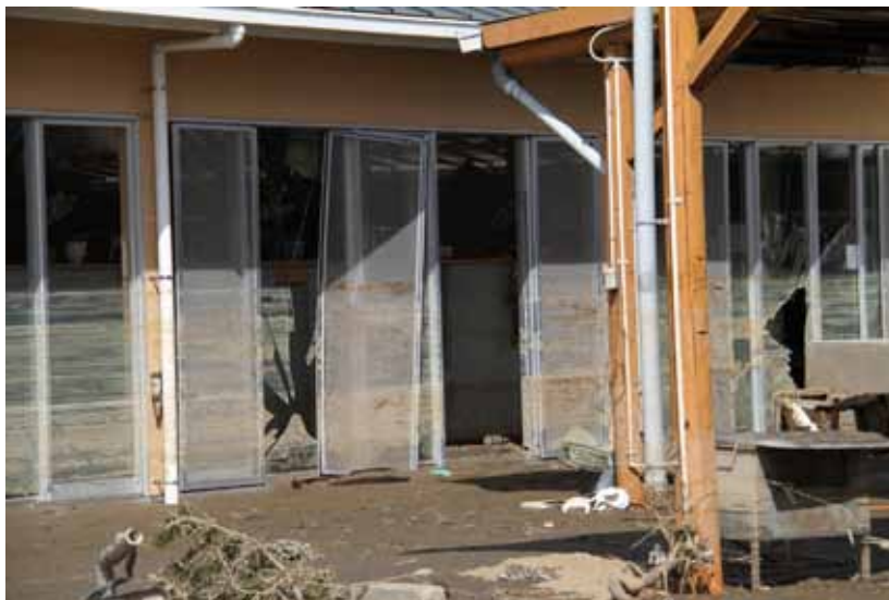
写真 2-2-28 津波による被害（山武市蓮沼地域：山武市提供）
