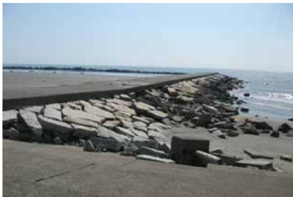
写真 2-1-5 海岸被害(旭海岸：旭市)
