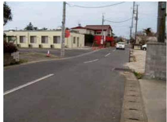
写真 2-3-26 旭市篠堆 砂鉄採取跡地部分が沈下し、道路には地波がみられる (3/20)
