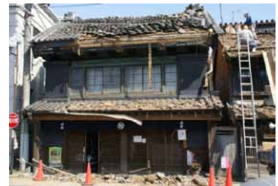
写真 2-1-24 県指定文化財「福新呉服店」の被災状況 (提供：香取市教育委員会)
