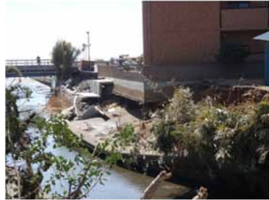
写真 2-2-14 矢指川右岸の河口付近 護岸崩壊及びマンションの基礎洗掘 (旭市横根)
