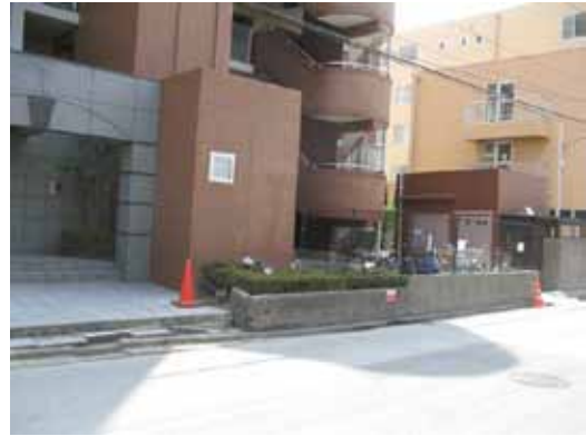
写真 2-3-4 浦安市今川 構造物の抜け上がりは20cm程度
