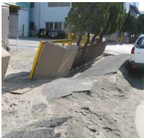
写真 2-3-3 鉄鋼団地 大量の噴砂とコンクリート塀が沈み込み大きく傾いた。
