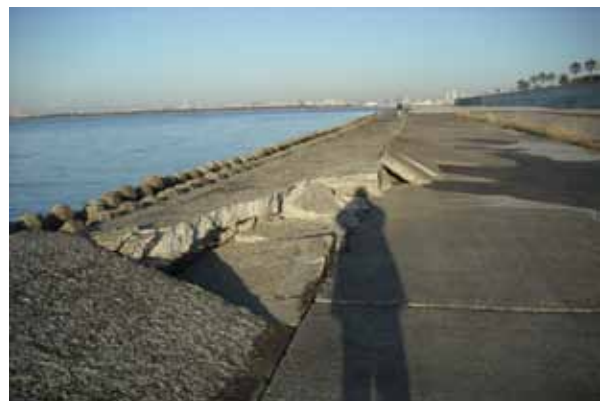
写真 2-1-6 海岸被害(浦安海岸：浦安市)
