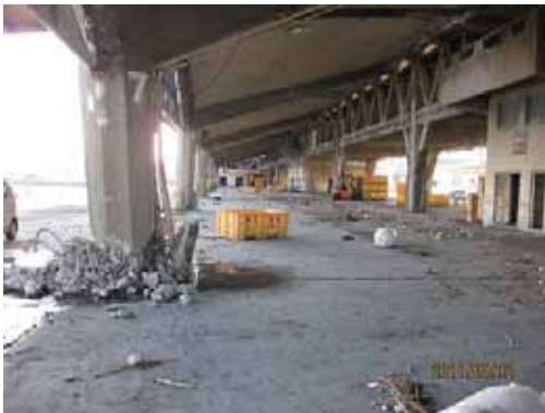
写真 2-1-11 銚子漁港第一市場の柱が崩壊
