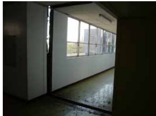
写真 2-1-14 香取市立新島中学校 エクスパンション部分の断裂（香取市提供）
