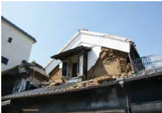
写真 2-1-21 県指定文化財「旧油惣商店土蔵」の被災状況 (提供：香取市教育委員会)
