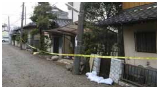
写真 2-3-20 我孫子市布佐西町 道路の変形と家屋・塀の傾き 深刻なところでは 1m 程度の沈み込みもみられる（3/22）
