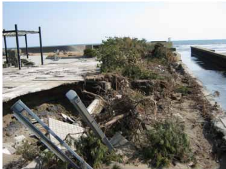
写真 2-2-15 矢指川左岸の河口付近 (矢指橋東岸) 内陸への津波の進入口となった。 松や支柱が上流側に倒れている。 (旭市椎名内)
