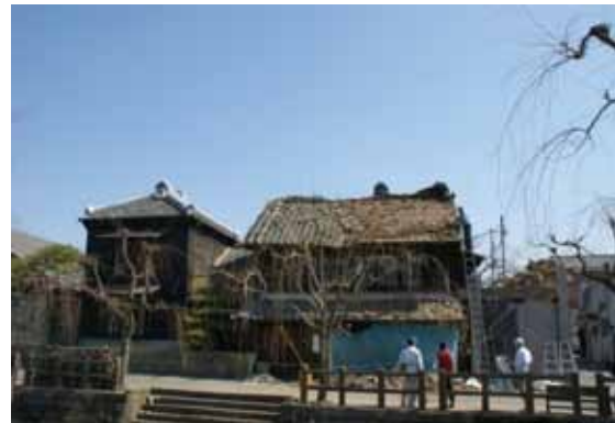
写真 2-1-22 県指定文化財「正上醤油店」の被災状況 (提供：香取市教育委員会)
