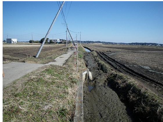
写真 2-3-22 香取市谷中 噴砂で埋まった水路と液状化—流動化部分の大きな沈下 (3/18)
