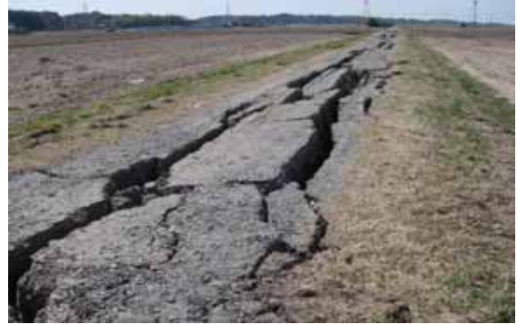
写真 2-3-32 用水路（塩化ビニル管）埋設箇所沈下
