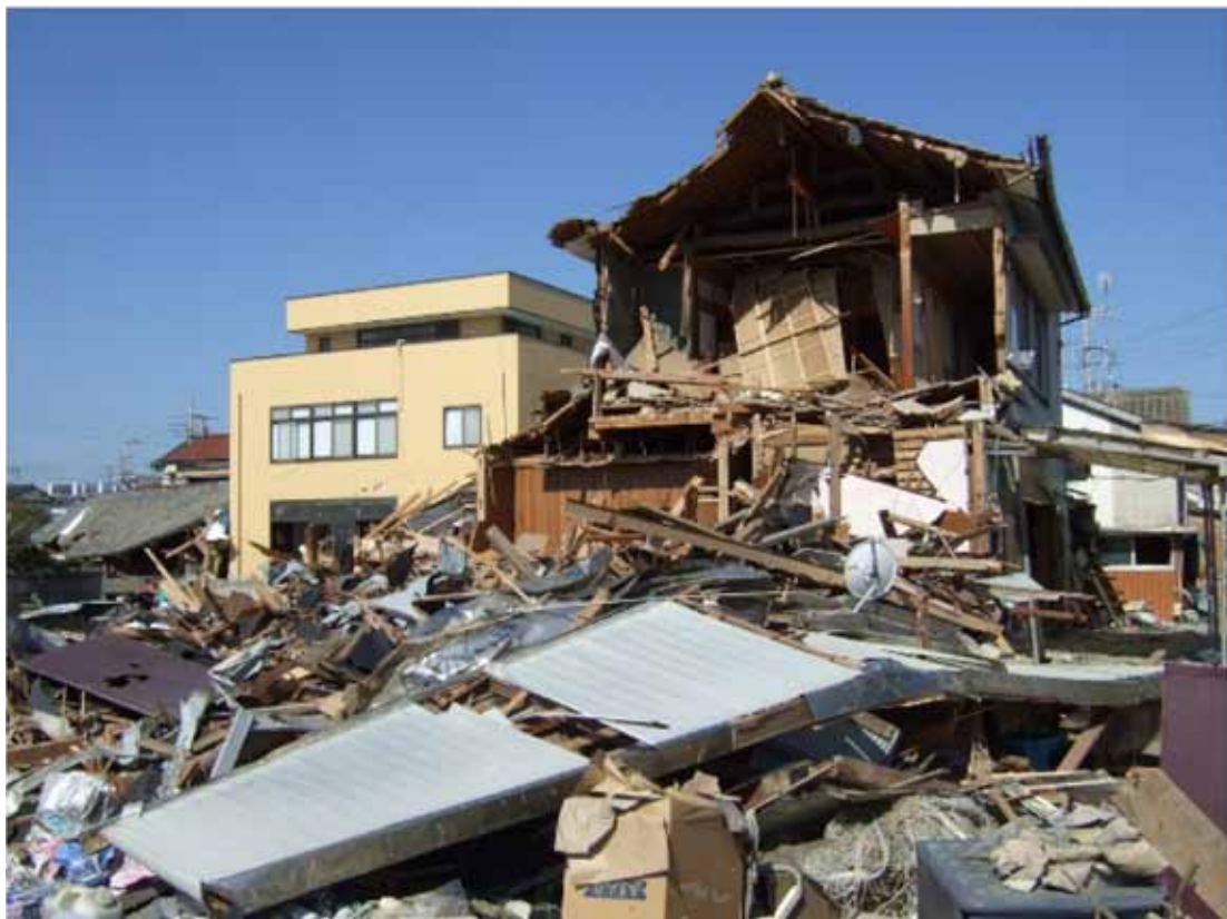
写真 2-2-10 倒壊した木造家屋と窓ガラスが破損したコンクリート造りの家（旭市飯岡）
