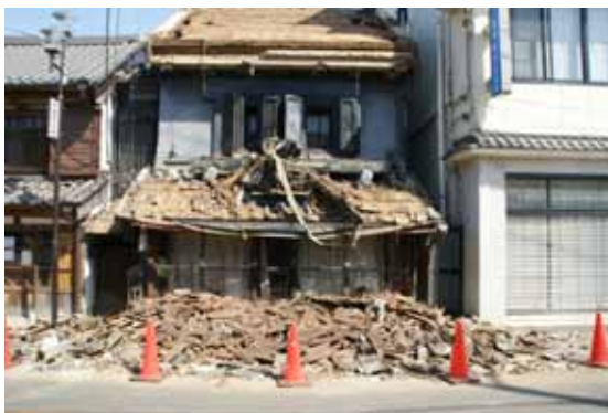
写真 2-1-23 県指定文化財「正文堂書店店舗」の落下した屋根瓦 (提供：香取市教育委員会)
