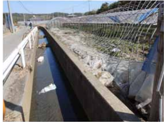
写真 2-2-12 水路脇のビニールハウス倒壊 (旭市平松)
