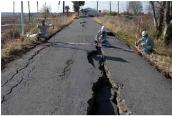
写真 2-1-1 道路被害(県道鎌ヶ谷本埜線)
