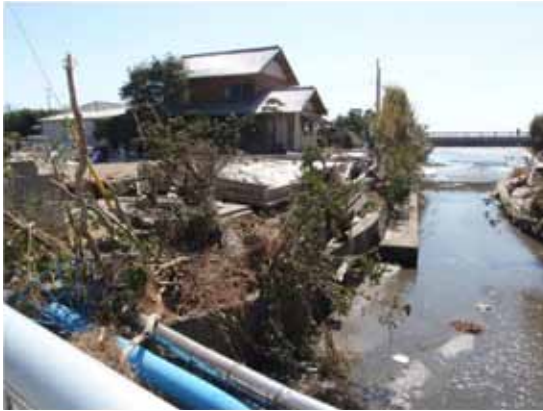
写真 2-2-13 矢指川左岸の河口付近 護岸崩壊 (旭市横根)
