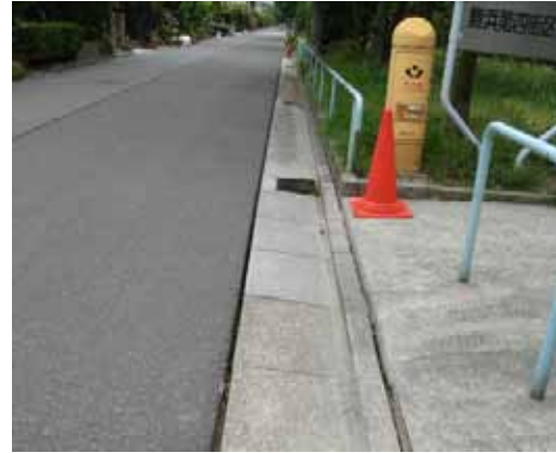
写真 2-3-8 浦安市舞浜道路の端に数センチの隙間が空いたり、数センチの沈下がみられる程度の変形がみられている。
