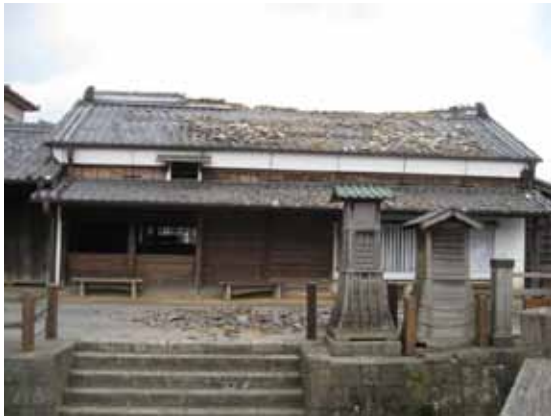
写真 2-1-19 国指定史跡「伊能忠敬旧宅」の被害状況 (提供：香取市教育委員会)
