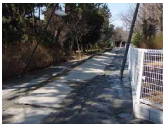
写真 2-3-12 習志野市袖ヶ浦 噴砂と地表の変形、電柱の傾動 (3月中旬)
