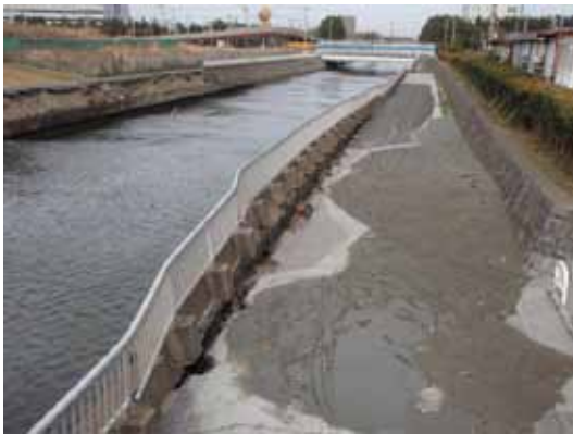
写真 2-3-16 習志野市芝園 茜浜と海浜霊園の間にある菊田川の水路左岸 左岸側では液状化した 噴砂が認められ柵が波打ち水路側に張り出している（3/14）
