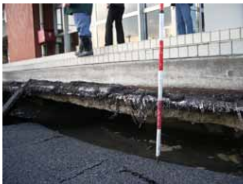
写真 2-1-13 県立浦安南高等学校 校舎周辺の地盤沈下
