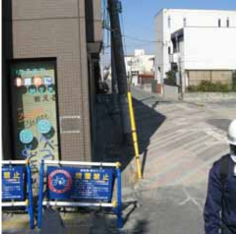
写真 2-3-1 浦安市入船 3階建てのビルが50cm程度沈降した。周囲の道路もいっしょに沈降し、電柱は大きく傾いた。
