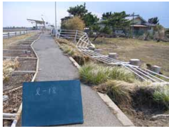
写真 2-2-18 有料道路ゲート付近の倒れた フェンス、有料道路用と歩道用の2列とも 倒れている（一宮料金所付近）
