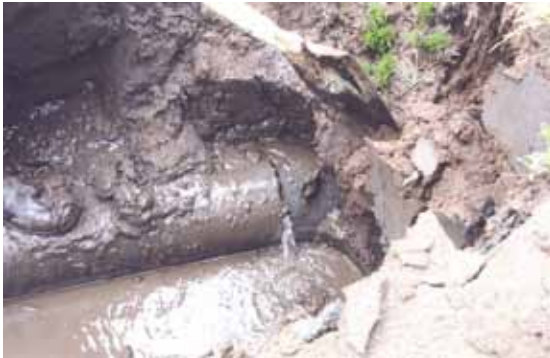
写真 2-3-31 用水路（石綿管）の破損・漏水
