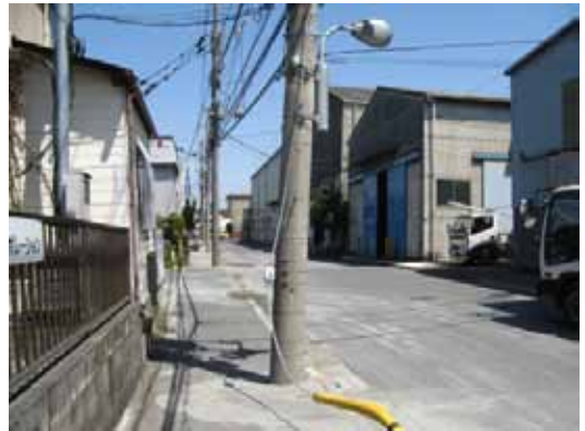
写真 2-3-18 浦安市鉄鋼団地 電柱の沈下（4/12）
