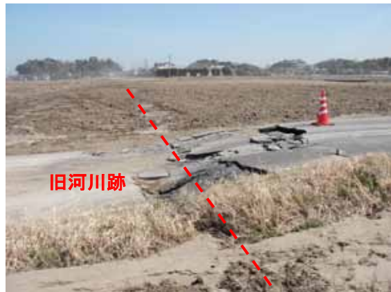
写真 2-3-27 河川跡に沿った沈下
