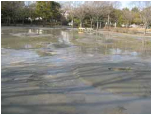
写真 2-3-11 千葉市美浜区磯辺 中磯辺公園での大規模な噴砂と大規模な沈下 (3/12)
