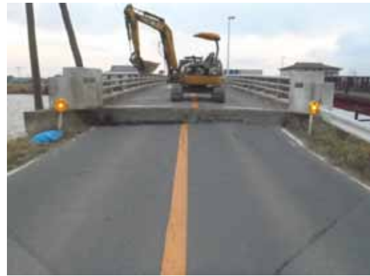
写真 2-1-2 橋梁被害(与田浦橋：香取市)
