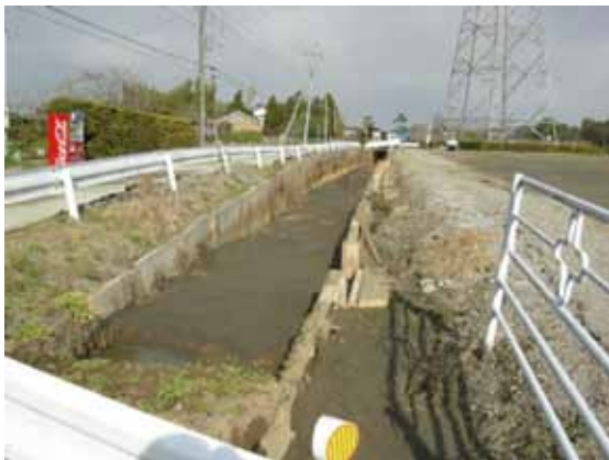
写真 2-3-33 排水路の噴砂による閉塞
