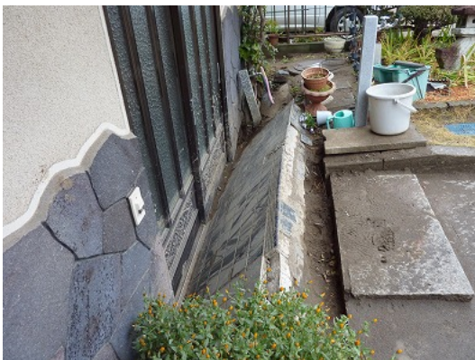
写真 2-3-19 我孫子市都 家屋の沈下・傾動。 敷地（庭）面との相対的な変化が大きく玄関前敷石が大きく家屋側へ落ち込んでいる（3/22）
