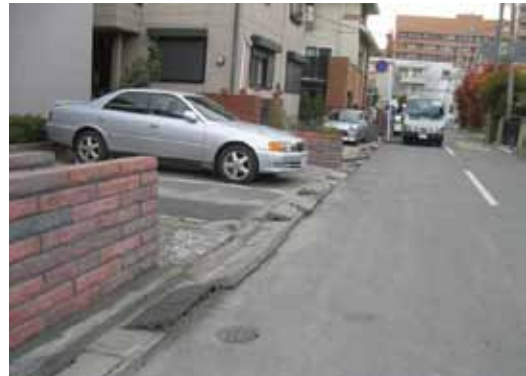
写真 2-3-5 浦安市今川 道路わきの住宅敷地部分は10~20cm沈下し、道路わきの排水路は波打っている。
