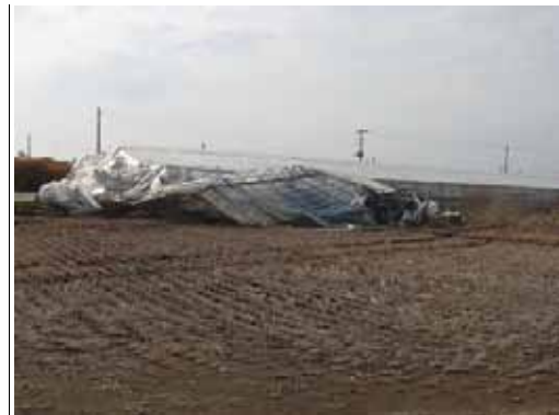
写真 2-1-12 津波で倒壊したハウス
