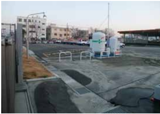
写真 2-3-9 千葉市美浜区新港 地下タンクの浮上と噴砂 (3/12)
