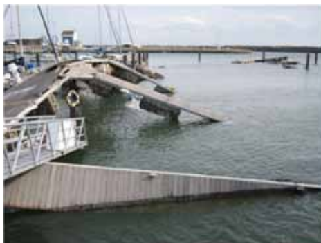
写真 2-2-6 損傷した栈橋 (銚子マリーナ)
