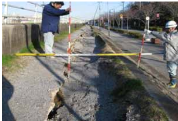
写真 2-1-3 河川被害(境川：浦安市)
