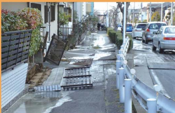
道路は隆起し、塀は倒壊（習志野市香澄）
