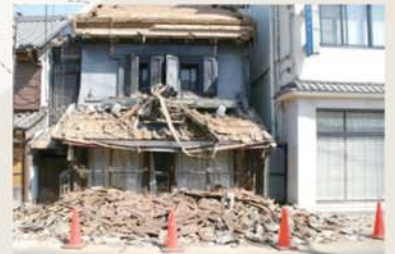
県指定文化財の被害状況 (正文堂書店店舗・香取市)
