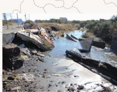
津波による被害 (目那川・旭市)
