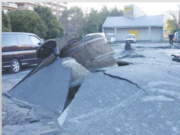
液状化によるマンホールの浮き上がり(浦安市高洲)
