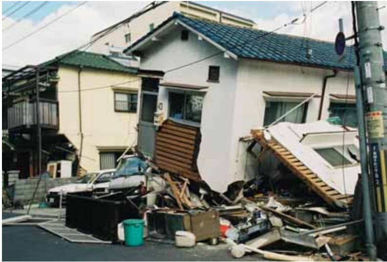
1階が倒壊した木造建物(阪神・淡路大震災)
