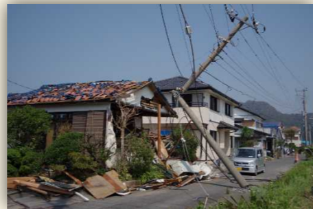
〔被災当時の電柱倒壊〕
