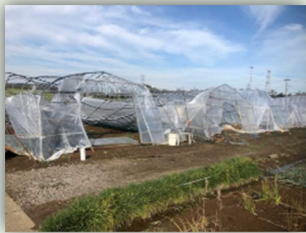
〔被災当時の壊れたビニールハウス〕
