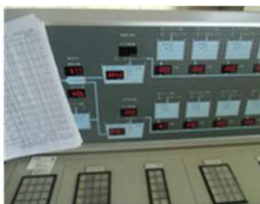
遠方監視制御装置
