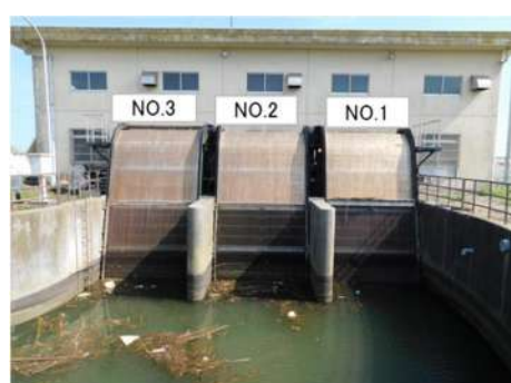
除塵機設備(全景)
