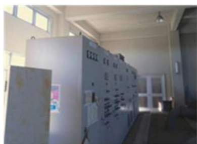
細草揚水機場電気設備
