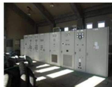
四天木揚水機場電気設備
