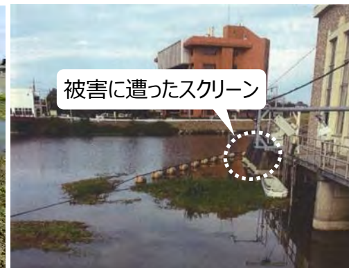
排水機場のスクリーン周辺に溜まり目詰まり
