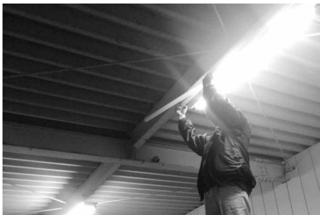
蛍光灯の飛散防止対策
