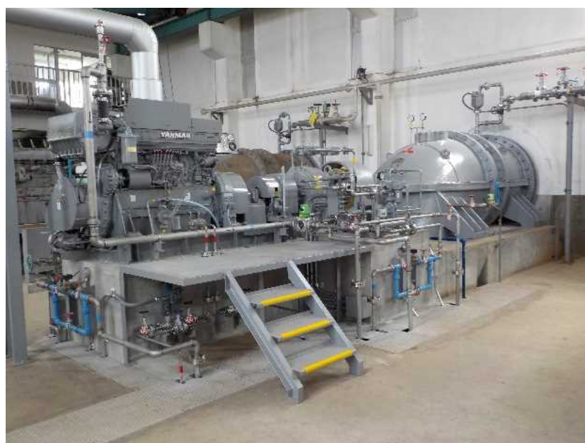
湛水被害を防ぐ排水ポンプ
